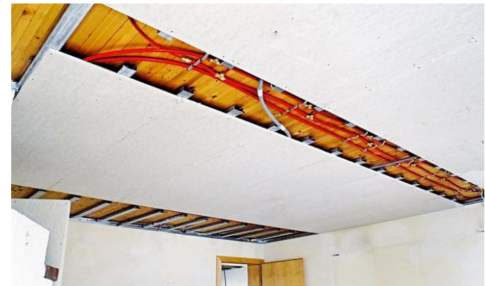
Foto: JOCO Deckenheizung
